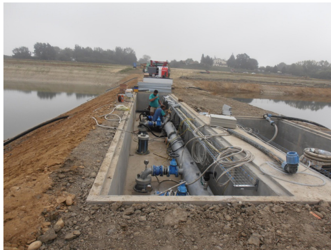
Impianti tecnologici ed idraulici nella stazione di pompaggio
