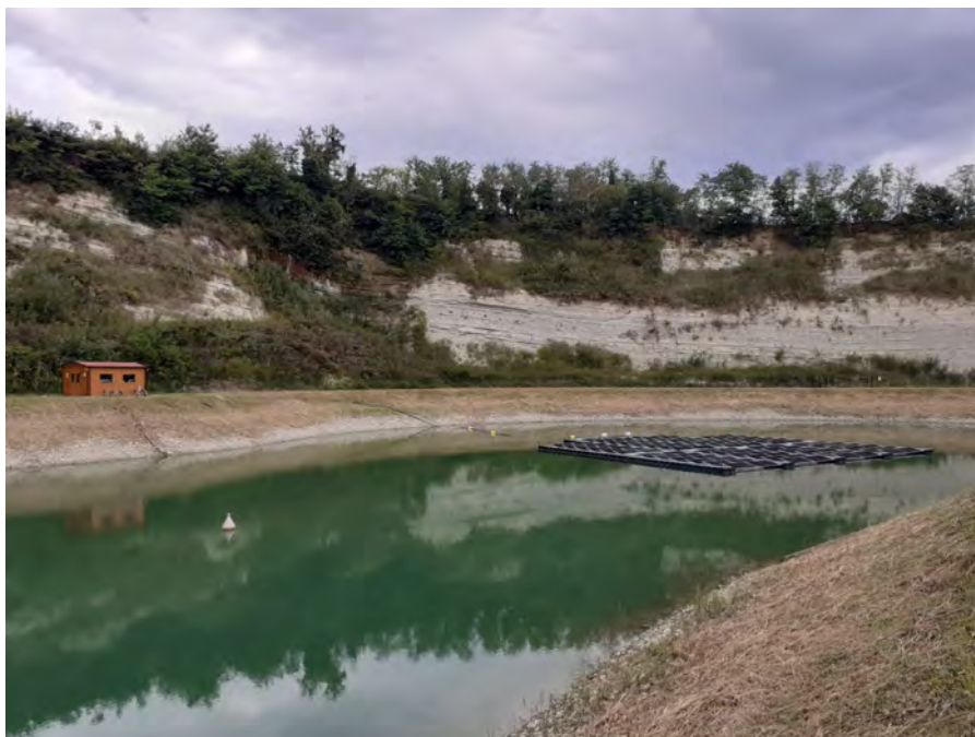
Vista dell'invaso Tuffo con l'impainto fotovoltaico da circa 60kW – Casola Valsenio (RA)
